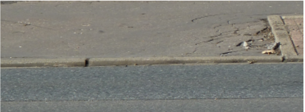
Solche unbequemen Bordsteinkanten wurden bemängelt.
